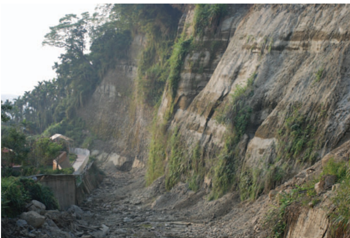
下圖：崩塌地順向坡土石鬆動。(攝影 / 顏新珠)
